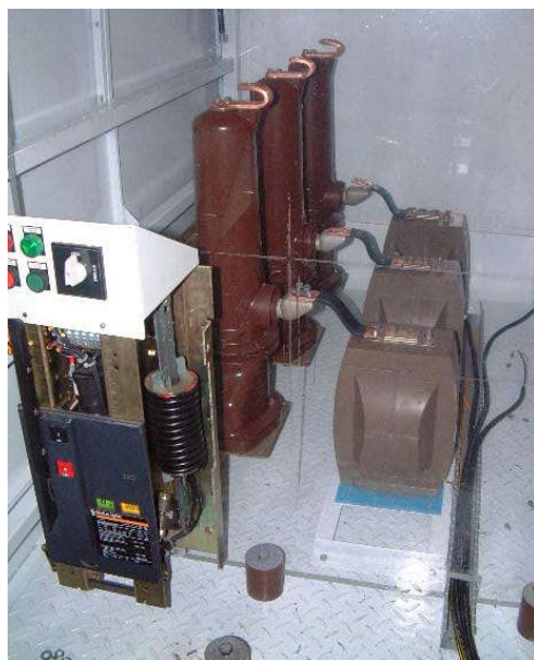
FIGURA 4: Detalle de los equipos de potencia
